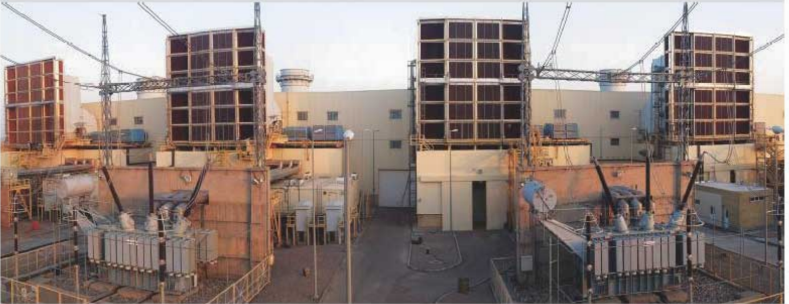
کولرهای مدیای بیرونی (بالادست) نصب شده در چهار واحد نیروگاه سیکل ترکیبی شهید کاوه قائن
